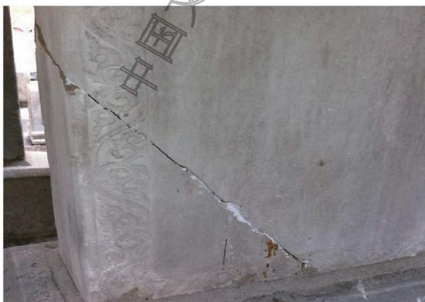
图 A.2 机械裂隙
